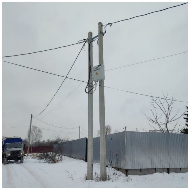
Рис. 1. Устройство секционирования линий электропередачи 0,4 кВ типа МКС-2-3В в ходе опытно-промышленной эксплуатации
